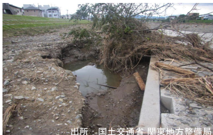
水害：台風19号の被害八王子市（2019）
