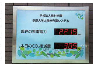
太陽光発電システム
