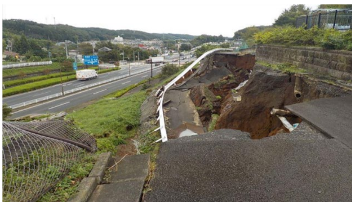
図表 2-10 法面崩壊により下水道管が断裂（八王子市生活安全部防災課，2020）
