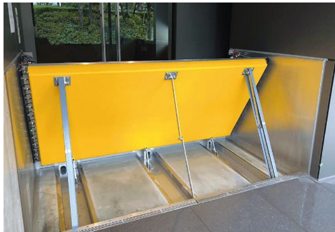
図表 2-26 入口に設置された、電気を使わず浮力で立ち上がる止水板（木村，2022）
