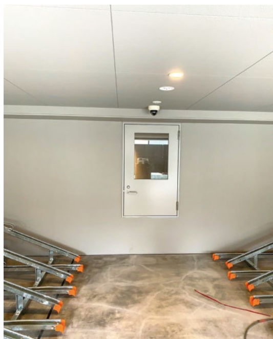
図表 2-27 一階の駐輪場に設けた避難用扉（木村，2022）
